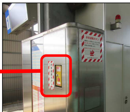
非常通報ボタン
