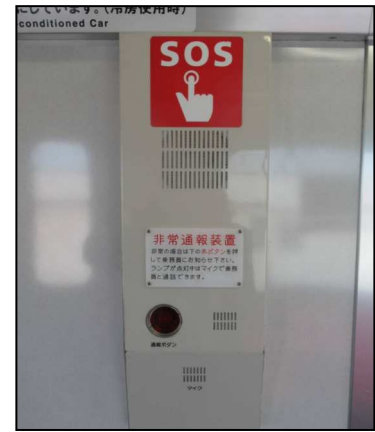
非常通報ボタン
