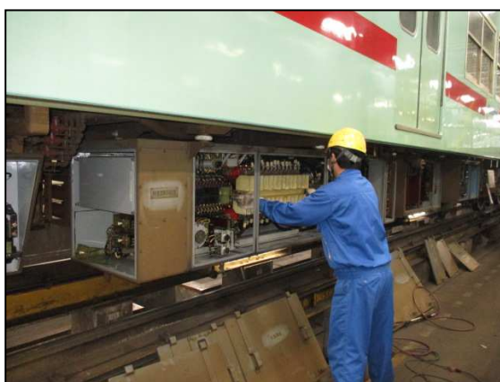
床下装置（制御装置）の点検
