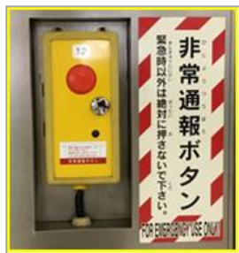
<非常通報ボタン>
