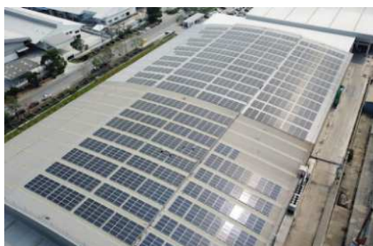
<太陽光パネル>
