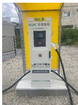
<電気バス充電設備>
