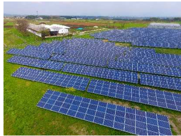
野立て太陽光発電設備
