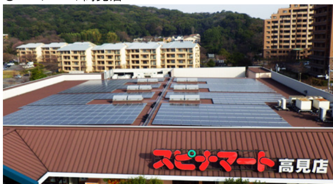
太陽光発電設備(屋根)
