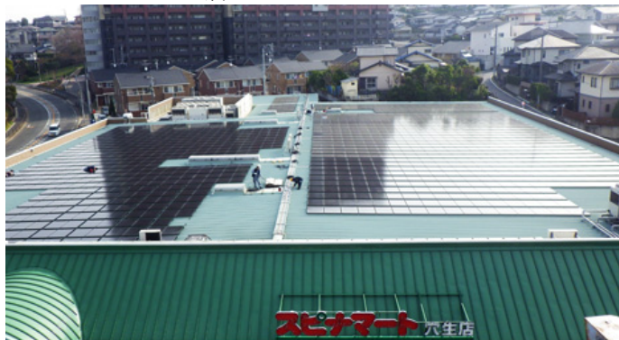
太陽光発電設備(屋根)
