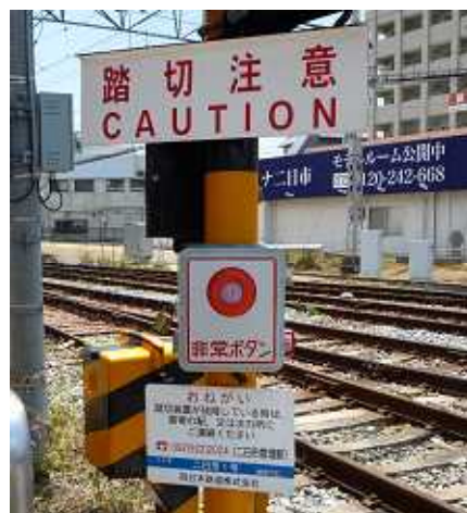
非常押しボタン
