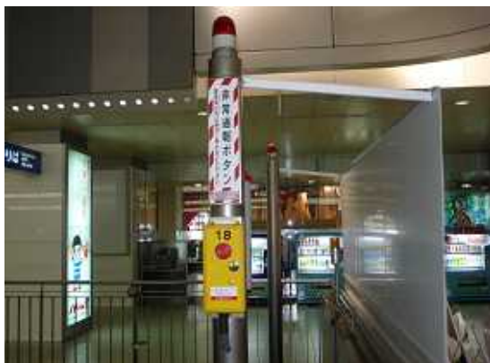
非常通報ボタン(ホーム)
