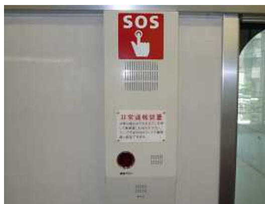
非常通報ボタン(列車内)
